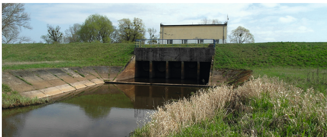
Przepompownia w ujściu Łasicy do Bzury w miejscowości Łasice. Okresowo jej działanie może mieć istotne znaczenie dla stanów wód w zachodniej części Puszczy Kampinoskiej
